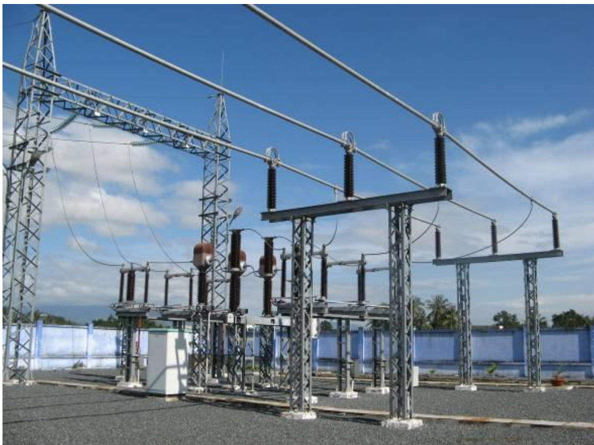
Trạm biến áp 110kV Bình Tân
